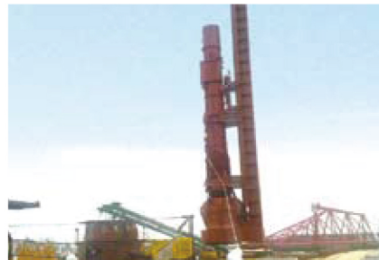
越南岘港码头D128柴油锤 Port of Da Nang, Vietnam. With D128
